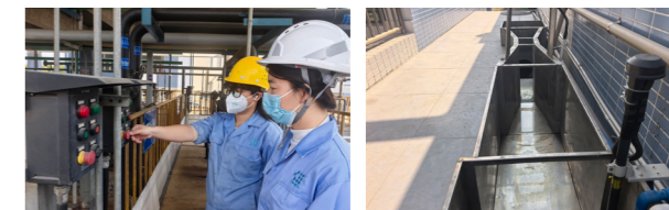
公司南沙厂区废水处理站
